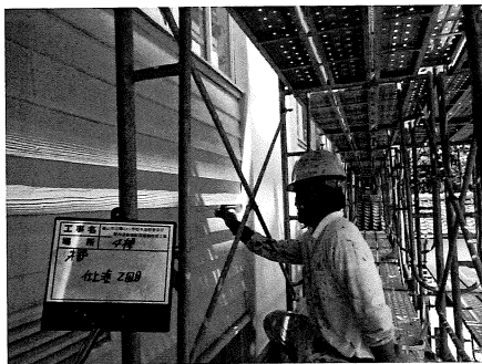
外壁下見板塗装
