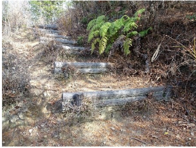
写真 6-7 段差の大きい擬木階段
