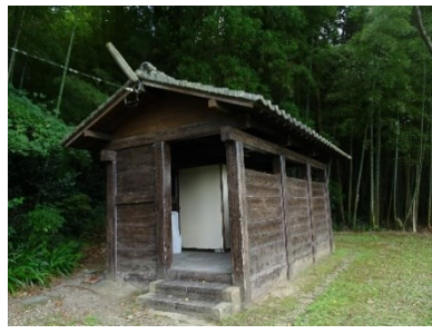
写真 6-8 老朽化しているトイレ
