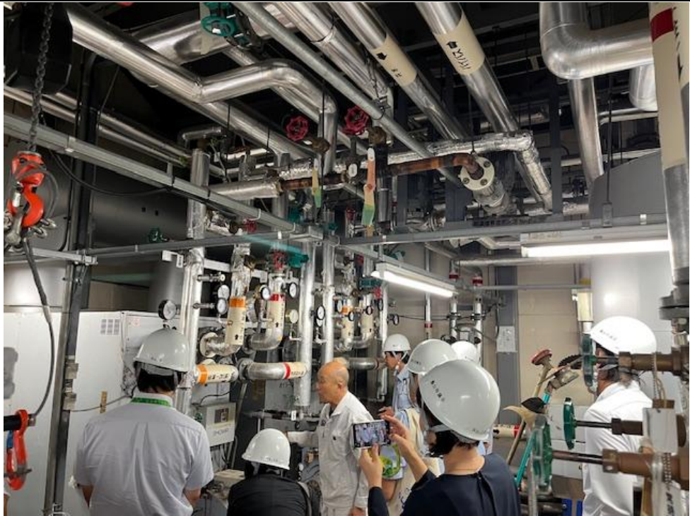
ボイラー室内 重油ボイラー
