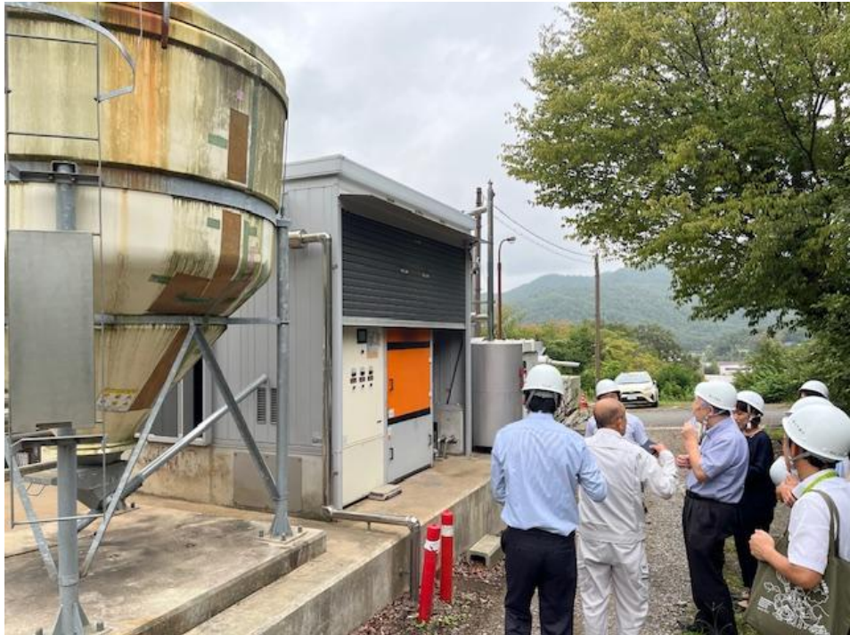
バイオマスボイラー
