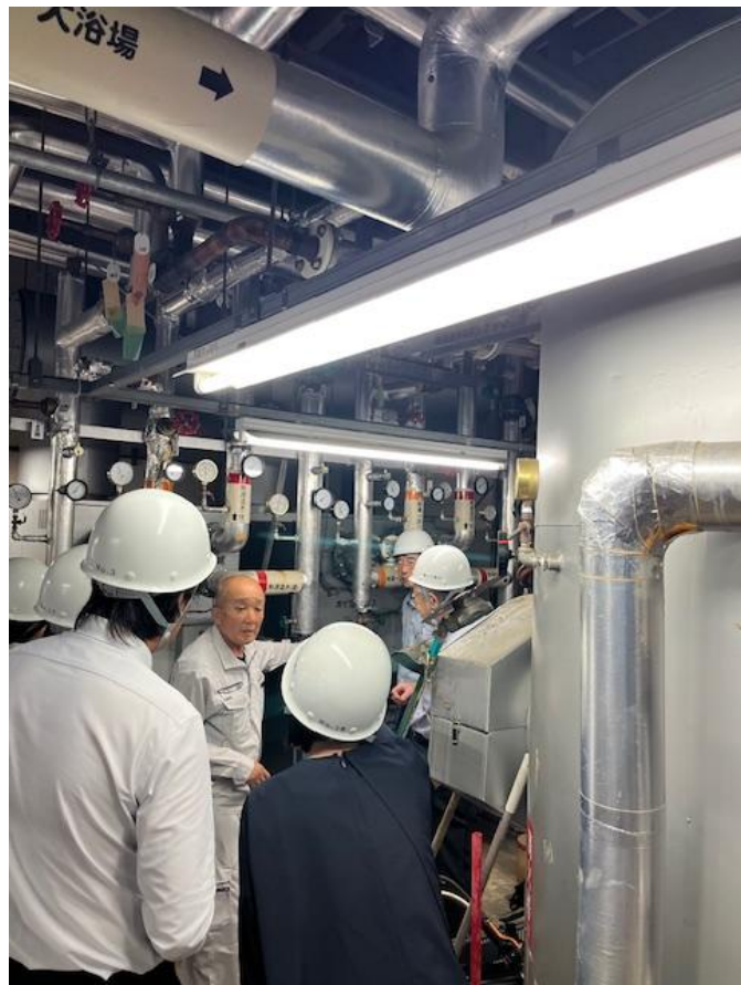
ボイラー室内 配管など
