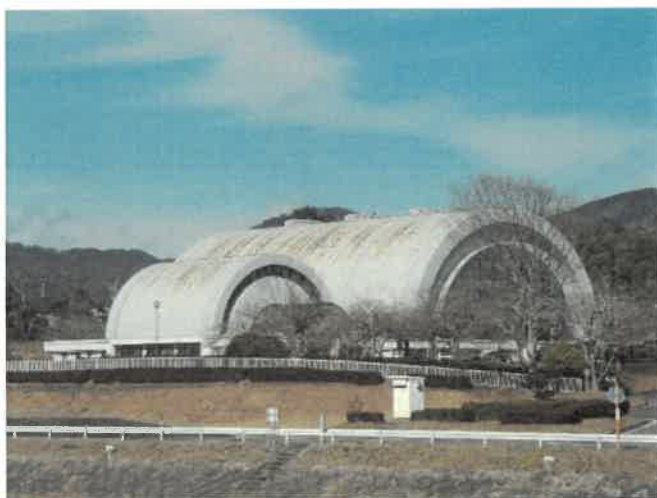
屋根の錆びた川代体育館
