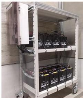
鉛蓄電池（密閉型） (8.2kWh)
