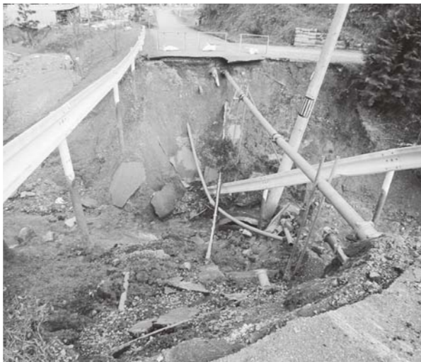
災害対策を万全に(台風被害現場)
