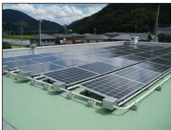
写真10：小学校の太陽光パネル
