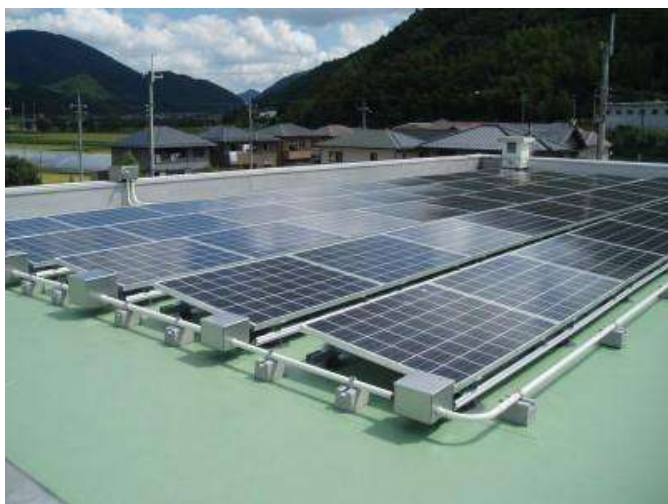
避難所には太陽光発電と蓄電池。いざというときも安心。
