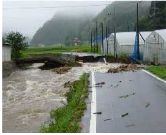
増水により決壊した道路
