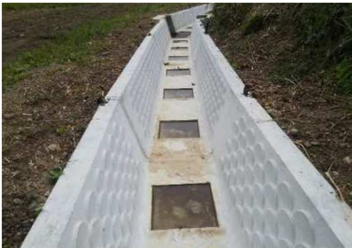
底面が凹み、壁面にうろこ状の凹凸
