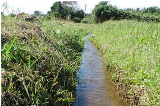
土羽水路に植生が繁茂
